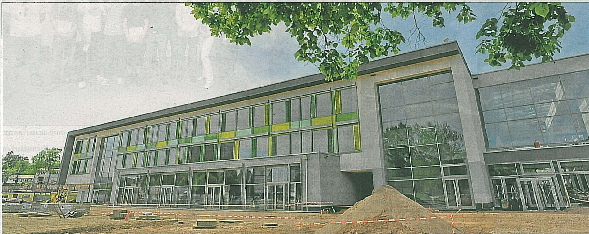
Nach den Weihnachtsferien wird in Mersch auf dem neuen Campus der Schulbetrieb beginnen.
